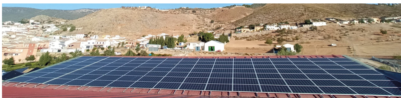
Fotovoltaica Roldán Oliva Íllora, Granada (2021)
