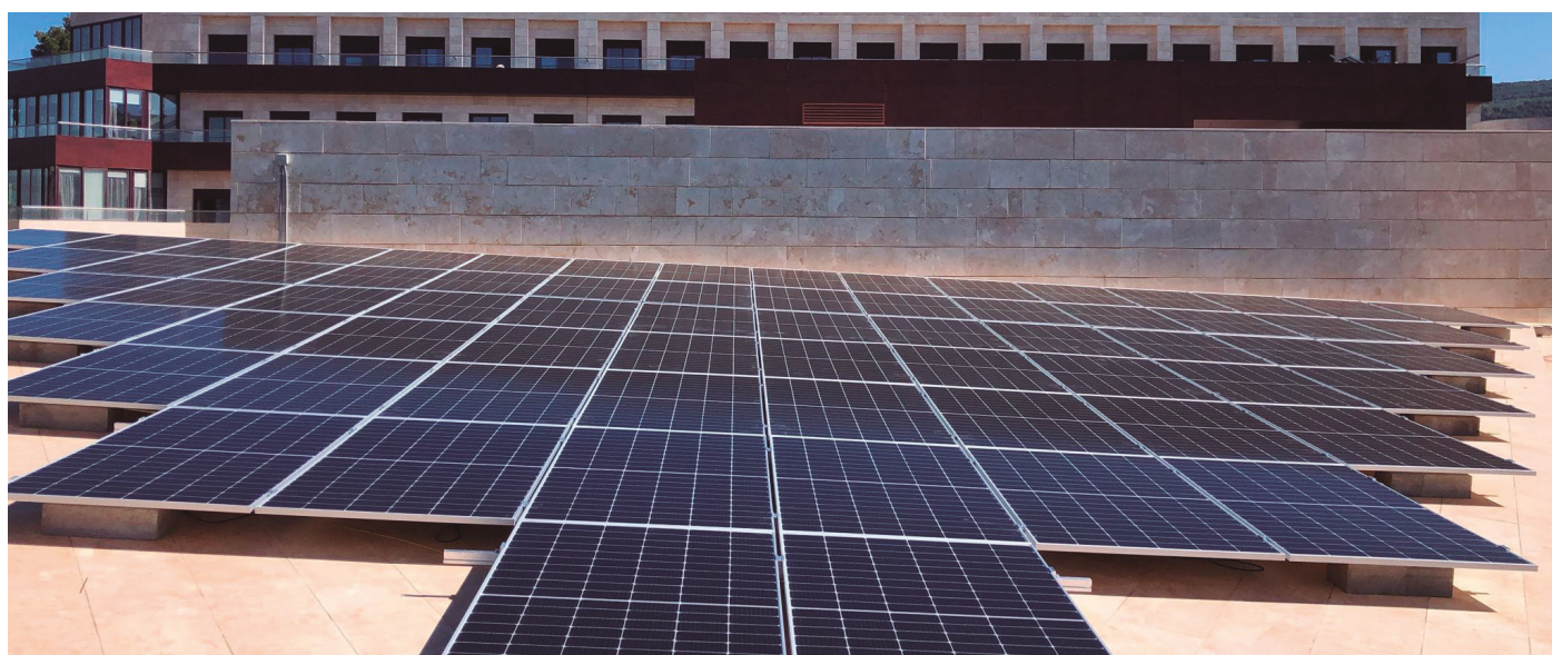
Fotovoltaica Residencia Fray Leopoldo Granada (2021)
