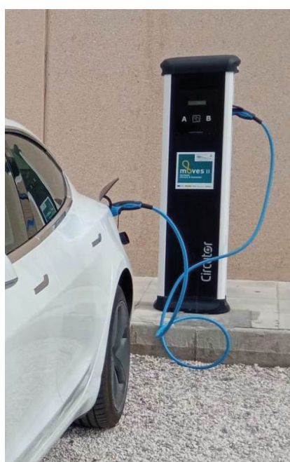
Cargador coches eléctricos. Pabellón deportivo Otura, Granada (2022)
