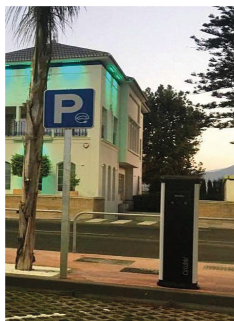
Cargador coches eléctricos. Autoridad Portuaria de Motril (2022)
