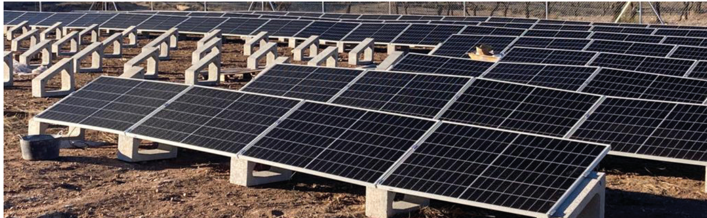
Planta fotovoltaica Ayuntamiento de Caniles (2022)
