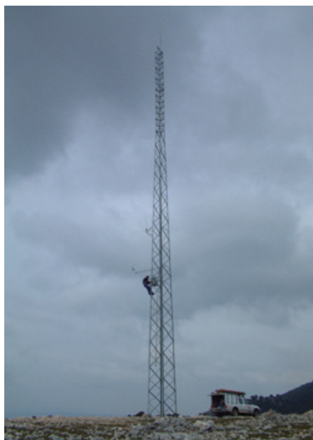
Torre Energía Eólica Sierra de Parapanda, Granada (2001)
